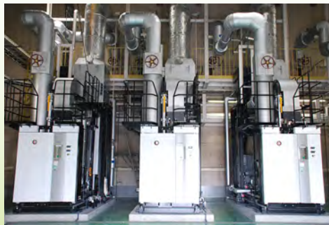
新ボイラーシステム
