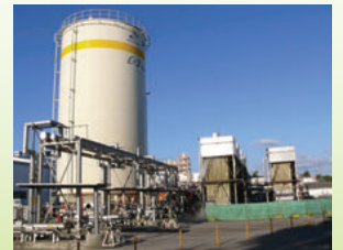
コ・ジェネレーションシステム
