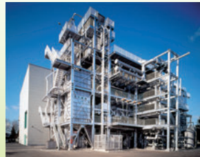
使用済みタイヤ焼却発電設備
