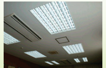
事務所内のLED照明
