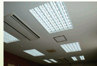
事務所内のLED照明
